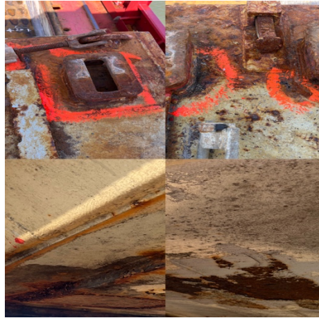
Lampiran 2.14 Gambar Korosi pada Hatch Cover
