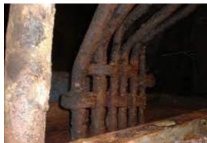
Gambar Korosi 2.11 pada Pipa Kapal
