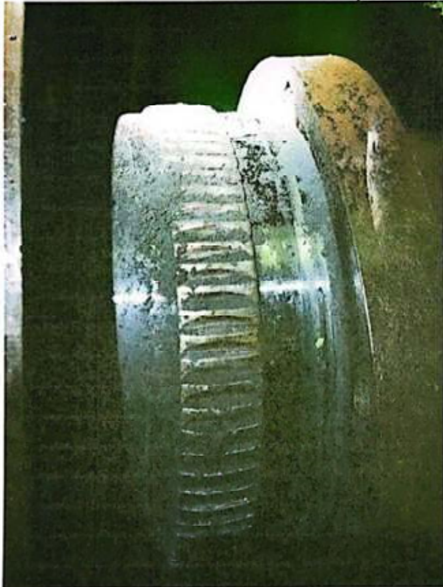
KONDISI GEAR PADA GEAR COUPLING SUDAH RUSAK
