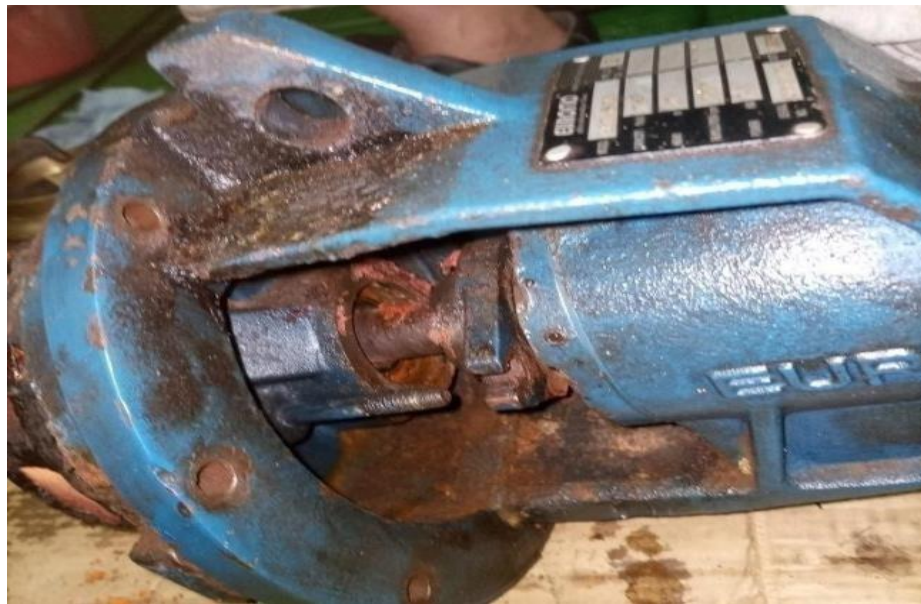
Gambar 3.5 Pompa pendingin yang mengalami kebocoran mechanical seal pada MT. Sea Reliance
