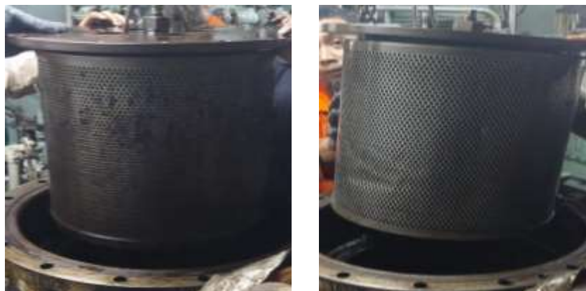
Gambar 3.4 : Perawatan filter bahan bakar
