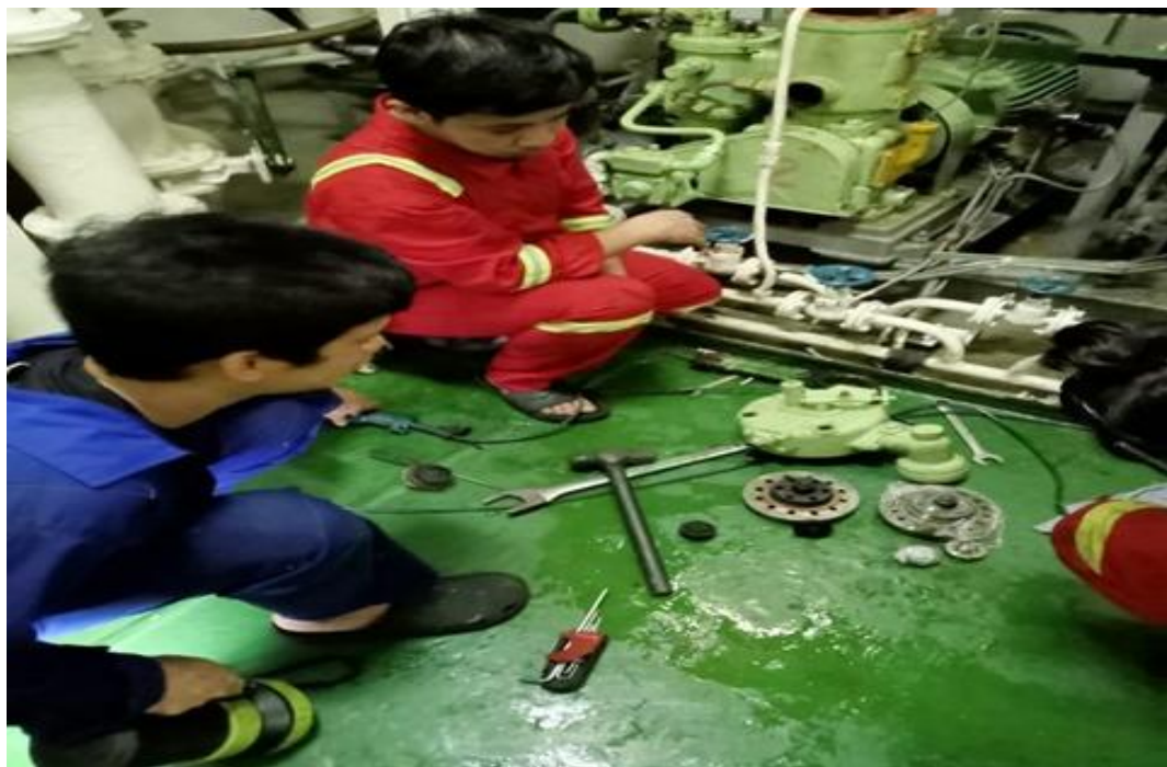
GAMBAR:PROSES OVERHAUL KOMPRESSOR UDARA
