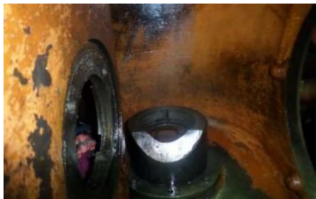
Gambar 4.5 Bearing housing yang kering akibat tidak adanya pelumasan
