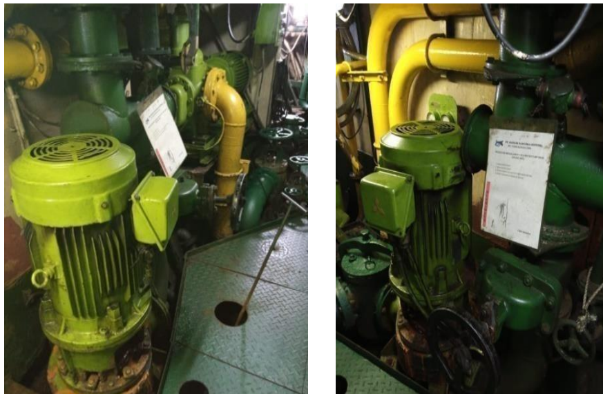
Gambar 2.2 dan 2.3 Pompa Pendingin Air Laut Mesin Induk
