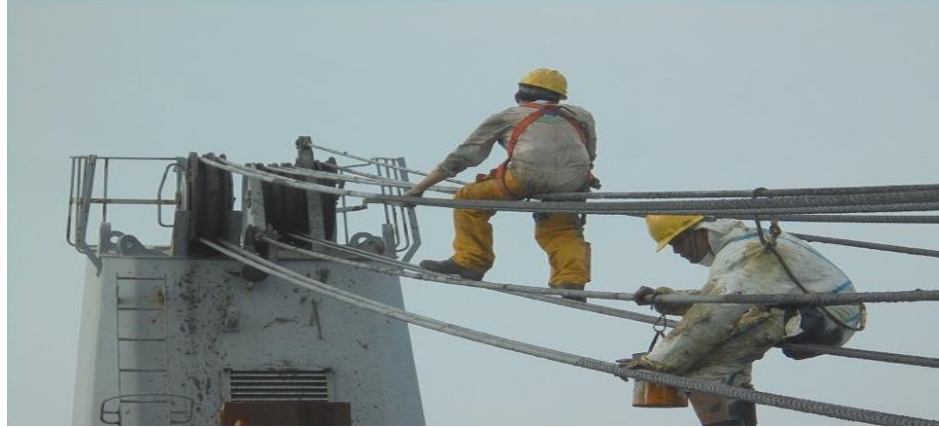
Gambar 4.5: Proses grease wire crane sebelum kejadian kecelakaan terjadi
