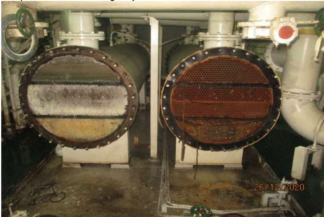
Lampiran 17. Korosi Yang Terjadi L.O Cooler
