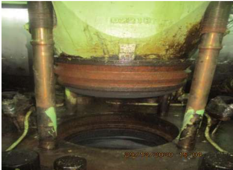
Lampiran 16. Korosi Yang Terjadi Pada Cylinder Head
