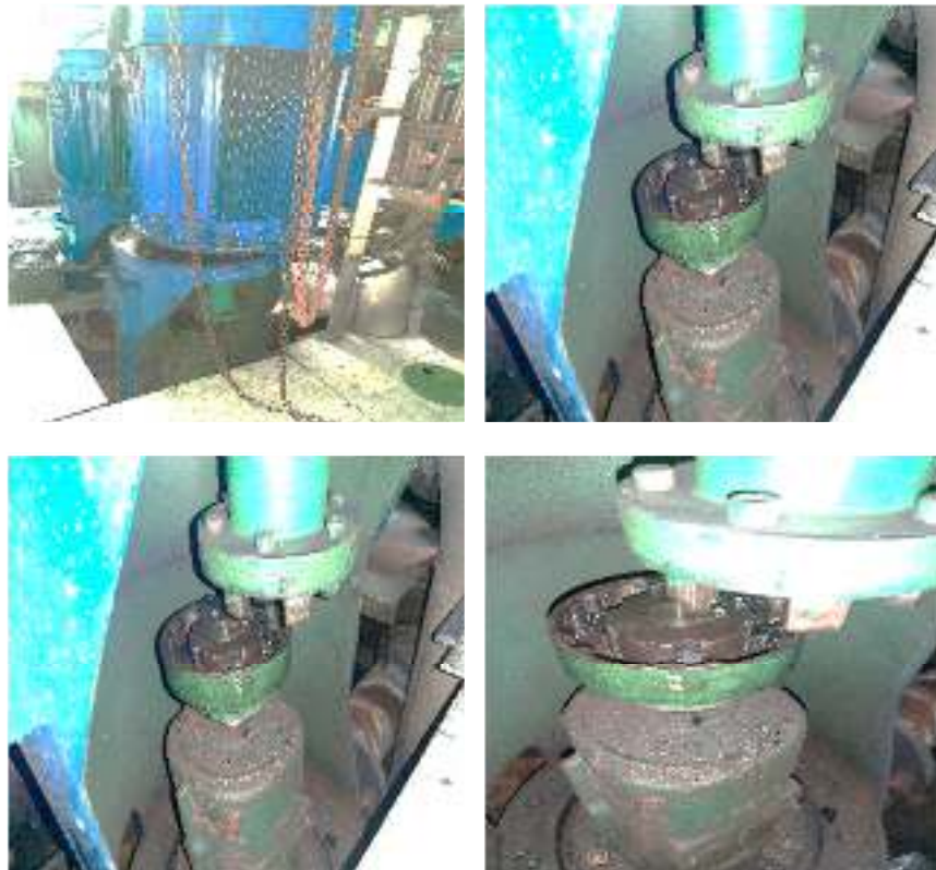
Gambar 3.5 : kondisi kerusakan rubber coupling pada pompa air laut
