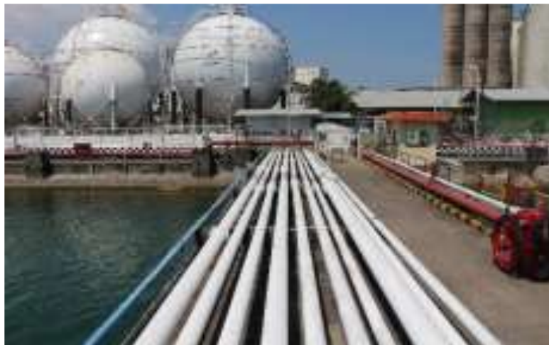
Gambar 4.2 Pipa Penyaluran BBM dari Tanker – Tangki Timbun (dan Sebaliknya)
