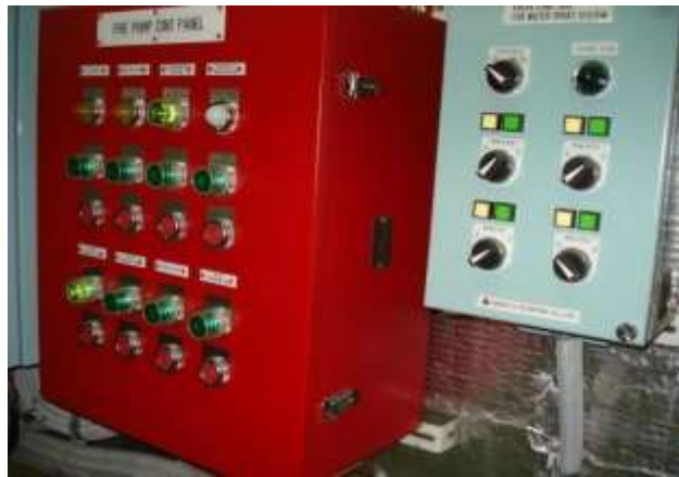
Gambar 4.4 Panel control yang menerima alur dari alat deteksi kebakaran
