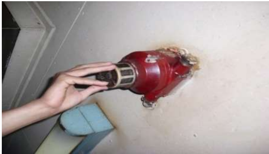
Gambar 4.1 Alat Deteksi Kebakaran Yang Tidak Terawat
