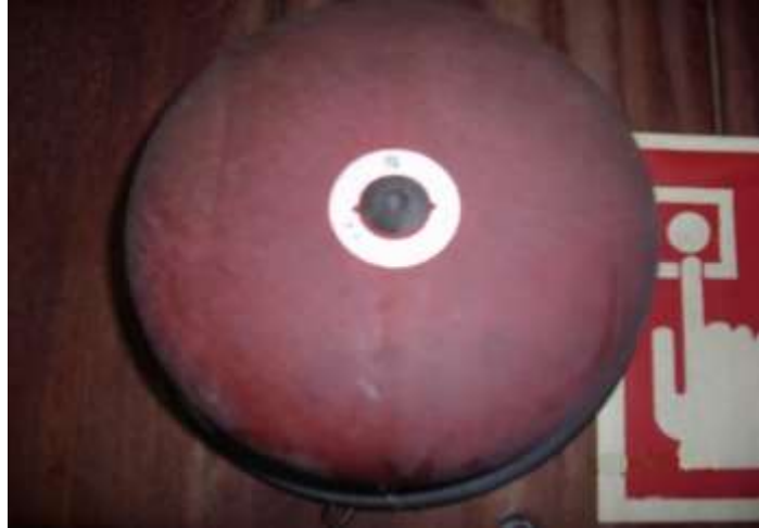
Gambar 4.5 Alarm kebakaran yang dapat memberikan tanda bahaya kebakaran
