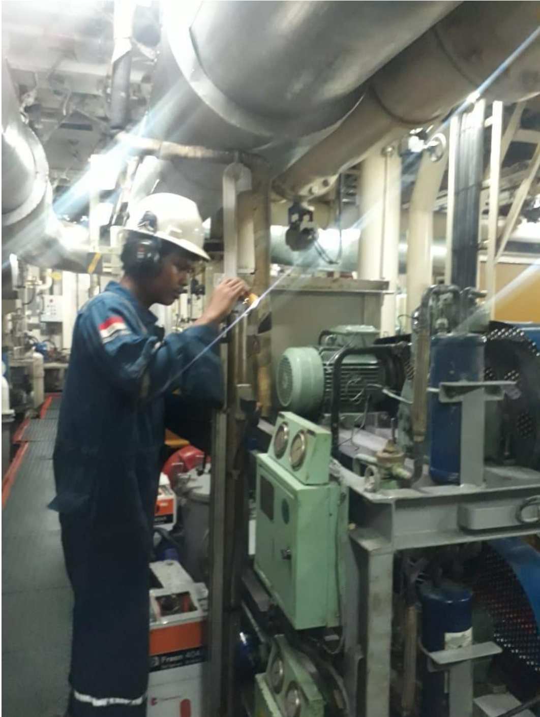
Lampiran 11 Pengecekan Instalasi Mesin Pendingin Oleh Cadet
