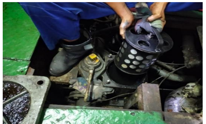
Sumber : Engine Room MT.TRIAKSA
