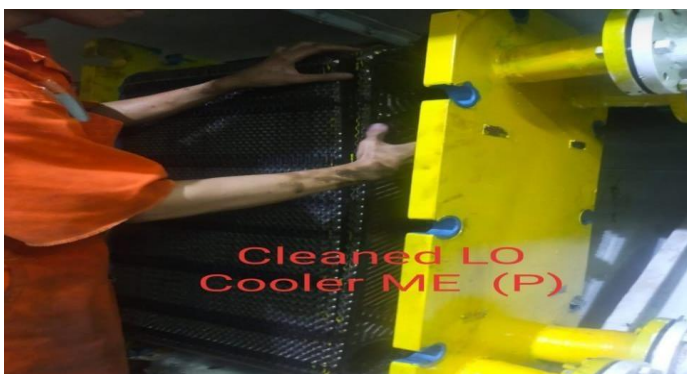
Sumber : Engine Room MT.TRIAKSA
