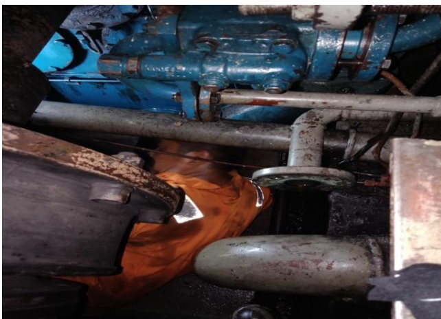
Sumber : Engine Room MT.TRIAKSA 17
