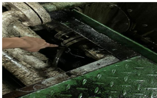
Gambar 4.1 : Saat Terjadi Kebocoran Pada Pipa Akibat Rusaknya Paking
