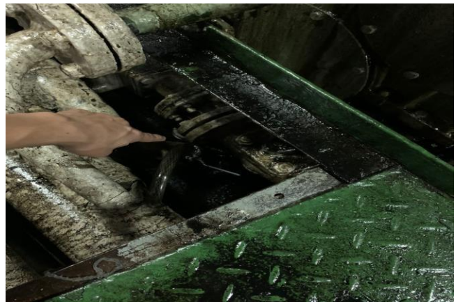
Sumber : Engine Room MT.TRIAKSA 17
