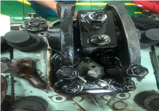
Sumber : Engine Room MT.TRIAKSA 17
