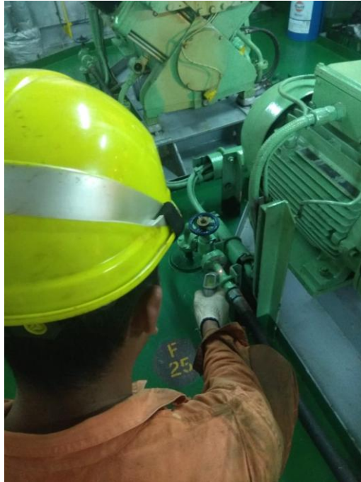
Gambar 4 2 Pengecekan Suhu Air Pendingin Pada Pipa Pendingin
