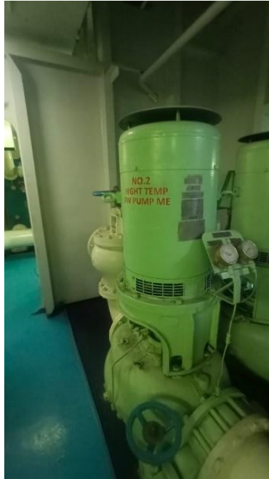
Gambar : pompa air tawar
