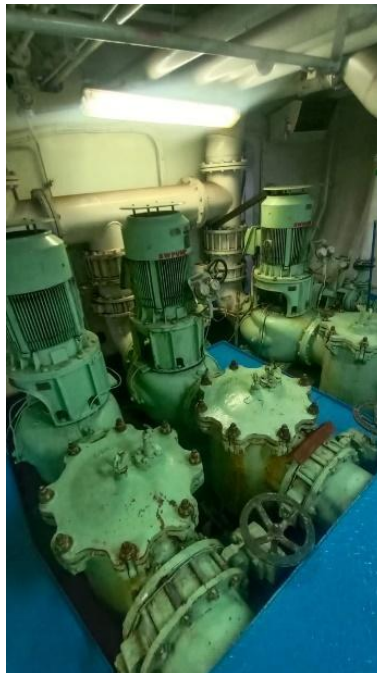
Gambar : pompa air laut
