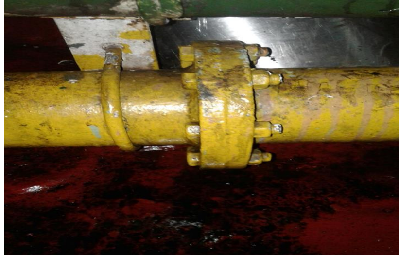
Gambar 4.1:Kebocoran pada pipa
