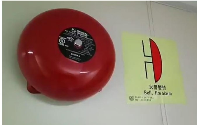
Gambar 2.5 Alarm Kebakaran Otomatis
