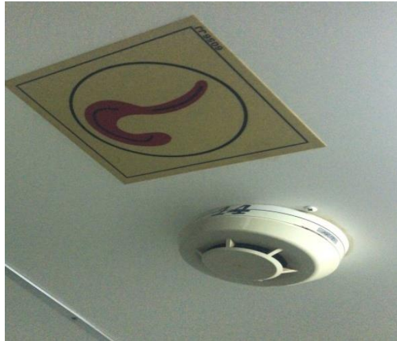
Gambar 4.3 Smoke detector kebakaran yang dapat berfungsi dengan baik .
