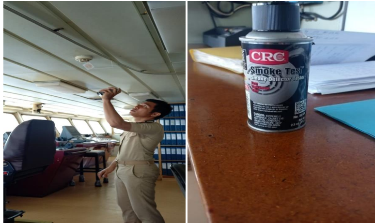
Gambar 4.7 Pengecekan/pengetesan pada smoke detector menggunakan smoke test
