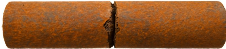
Gambar 2. 5 pipa korosi celah
