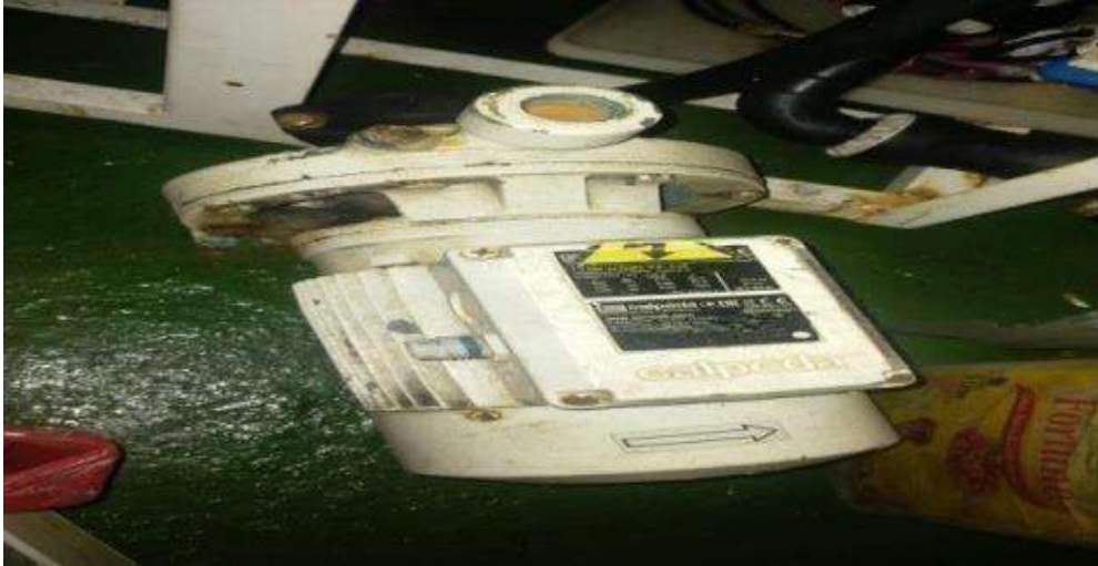
Gambar 2. 5 Sandfilter pump Sumber: Dokumentasi Pribadi MT. Sengeti
