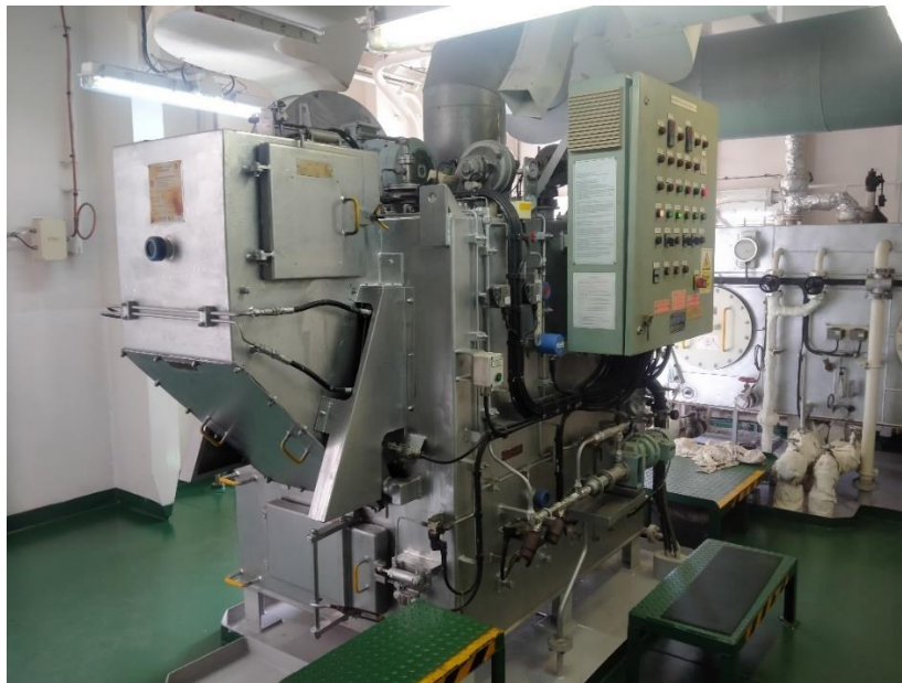
Gambar 2. 1. Pesawat Bantu Incinerator
