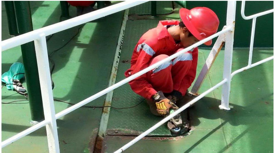
Gambar 4.2 ABK yang tidak memakai safety goggles saat kerja.
