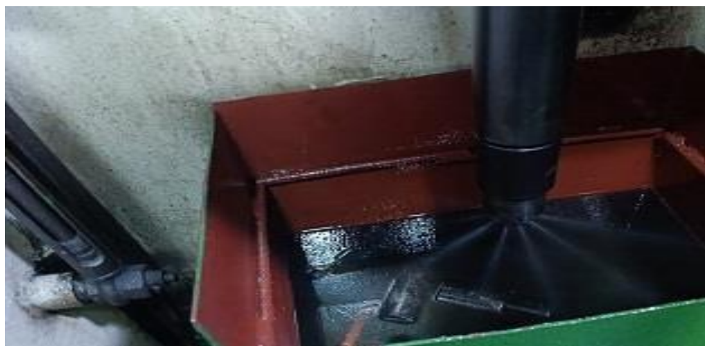
Gambar 2.2 Kondisi Injector atau lubang nozzle yang sudah melebar
