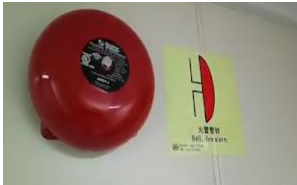
Gambar 2. 4 Alarm kebakaran otomatis
