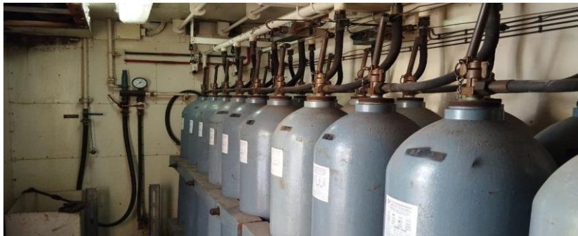
Gambar 2.2. Ruangan instalasi CO2
