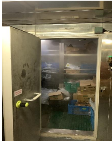
Gambar 4.2 Terbukanya pintu freezer
