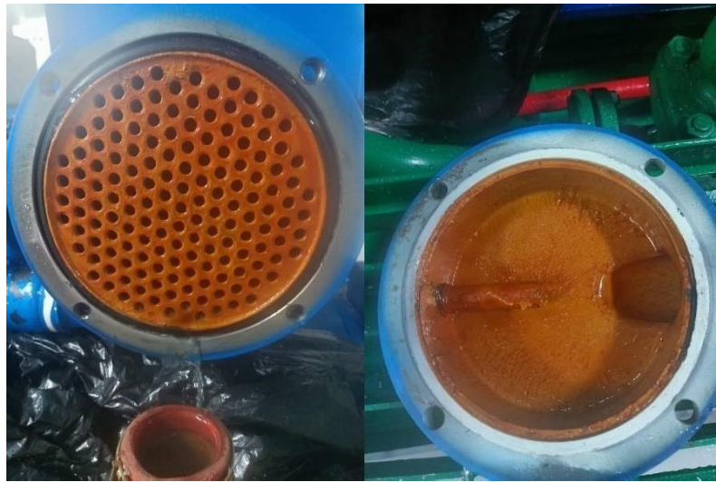
Gambar 11 Fouling Pada Pendingin Air Laut
